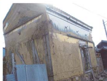
▲老朽化する土蔵の例
