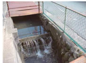
▲老朽化する排水路
