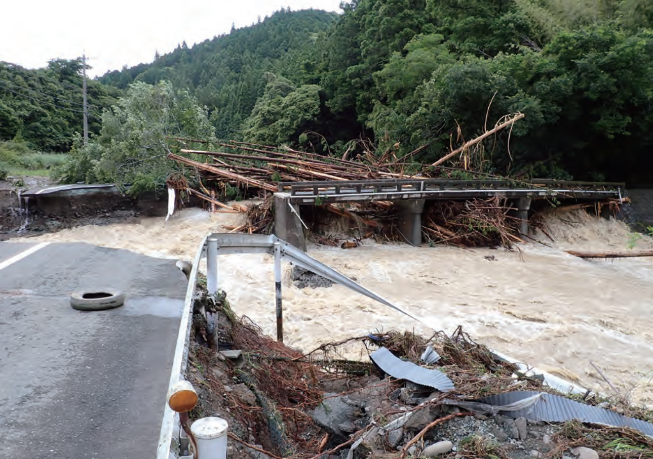
鍛冶島橋に大量の流木が詰まり越水し、県道大河内森線が崩壊
