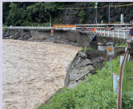
県道袋井春野線が崩壊(黒石市内)
