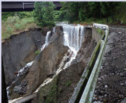
道路脇が大きく崩落(亀久保市内)
