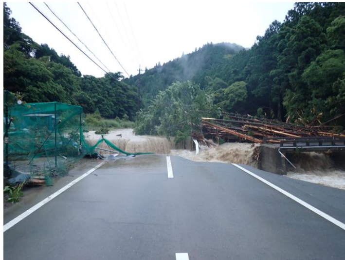
6月3日時点 県道大河内森線 通行止め (日月神社バス停付近)
