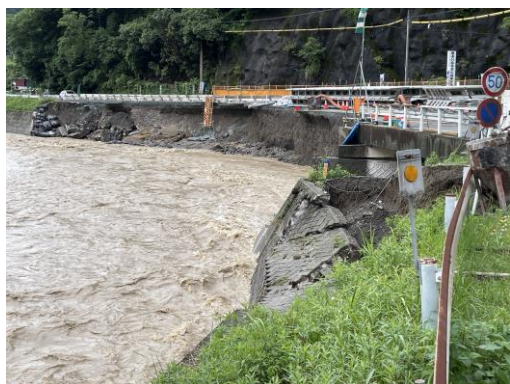
県道袋井春野線 通行止め (葛布入口バス停付近)
