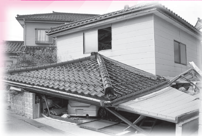
▲新潟県中越沖地震(平成19年7月)発生直後の被災家屋
