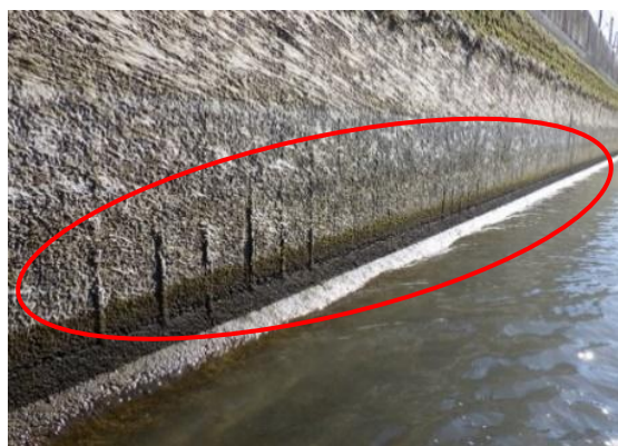
用水路の老朽化（鉄筋露出）
