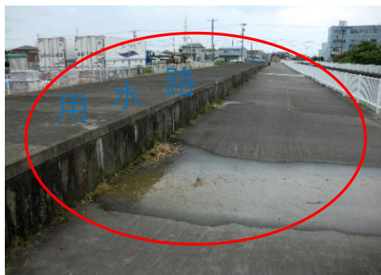
用水路からの漏水
