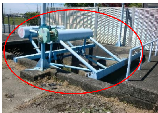
水位を上げる施設の老朽化
