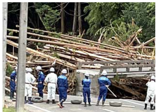
被害の様子（鍛冶島橋）
