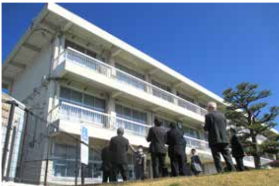
宮園小学校校舎の外壁はく離部を確認
