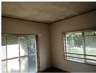
【やざき団地室内 カビの発生状況】
